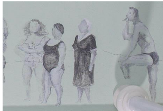
Fig. 40. Detalle de la grieta, Fuente propia
