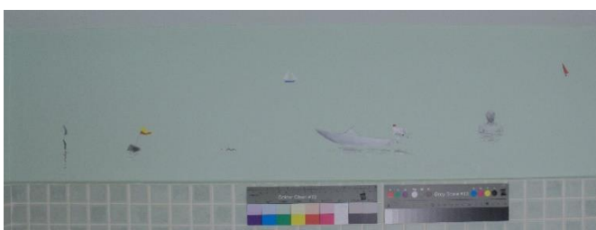
Fig. 28. Muro 4, Fuente propia
