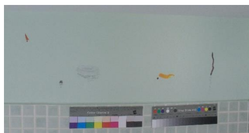
Fig. 29. Muro 4, Fuente propia
