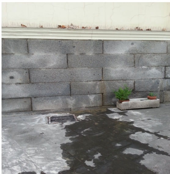
11. Filtración de agua por una de las fachadas del Museo Nacional de Antropología en el año 2015, por la rotura de una tubería, originando manchas y erosiones en la piedra. Foto: Sergio Boj.
