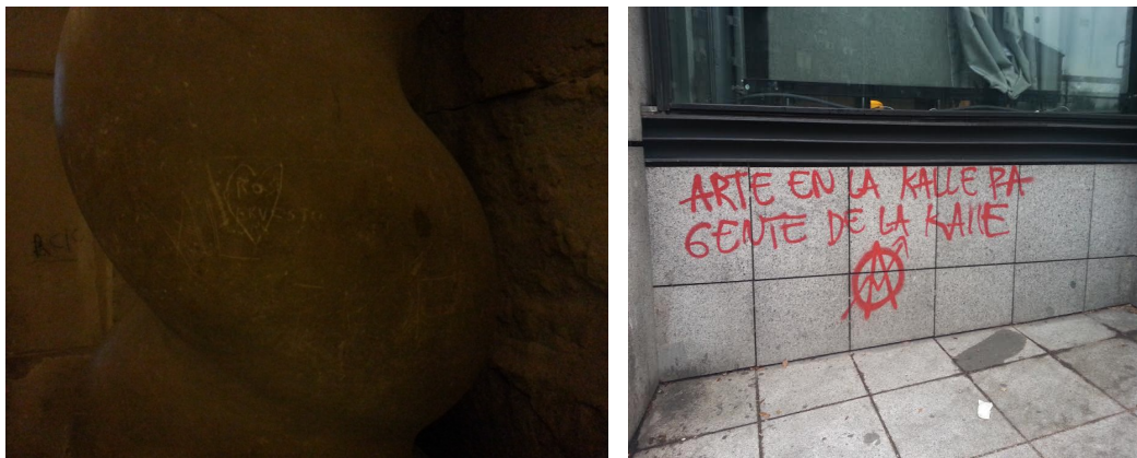
23. Columna dañada en la Basílica de Santa María de Elche (Alicante). 24. Grafiti en la fachada del MNCARS.
