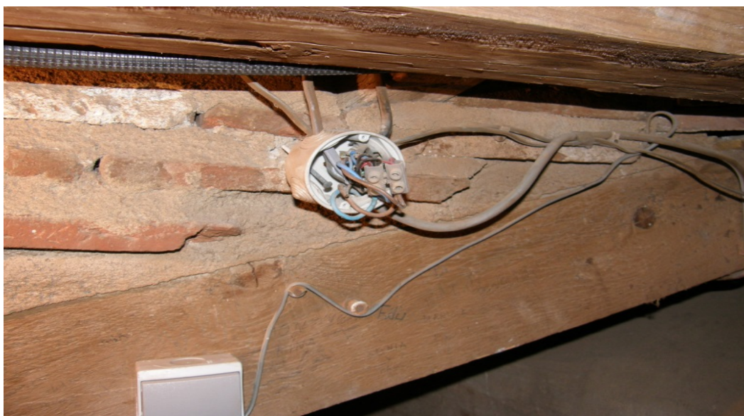
2. Detalle de una instalación eléctrica deficiente en el interior de un templo religioso y que pueden ocasionar un incendio en el mismo. Foto: Sergio Boj.
