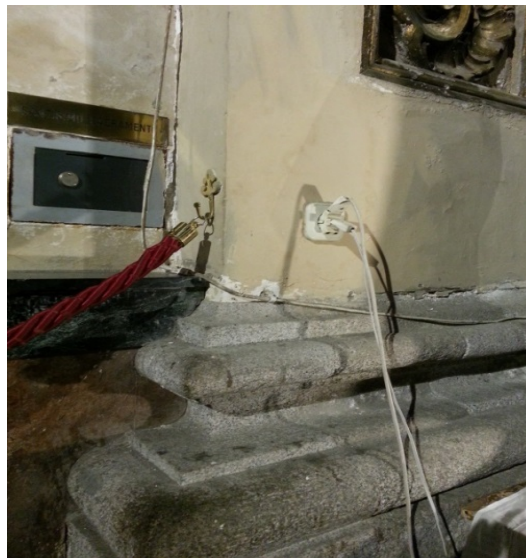
3. Imagen de la conexión múltiple en una toma de corriente eléctrica para la iluminación de varios altares en el interior de un recinto religioso. Foto: Sergio Boj.
