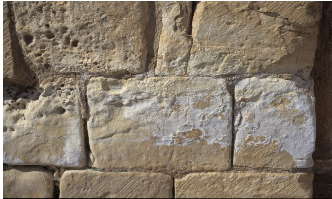
15. Salinización, erosión y desprendimiento de material en una fachada de piedra arenisca afectada por el agua. Foto: Montaña Galán.
