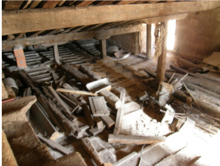
4. Acumulación de enseres y basura en la bajo-cubierta de un templo religioso. Foto: Sergio Boj.
