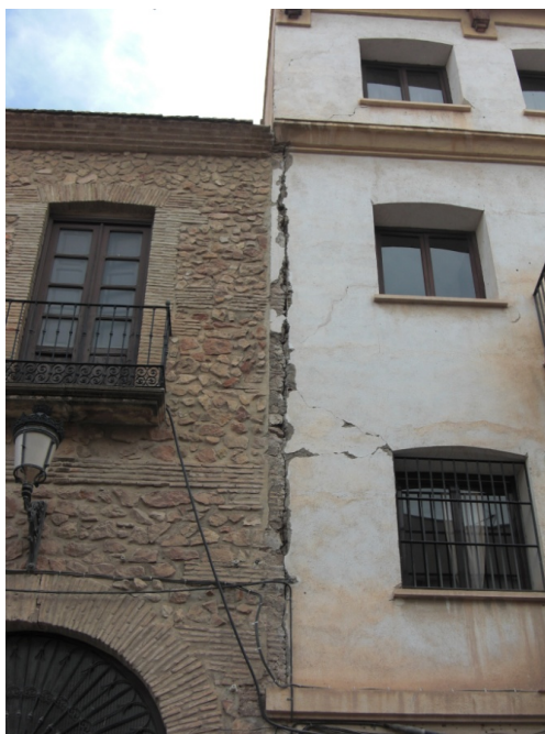
19. Separación de las juntas de dos edificios como consecuencia del terremoto de Lorca (Murcia) en 2011. Foto: Sergio Boj.
