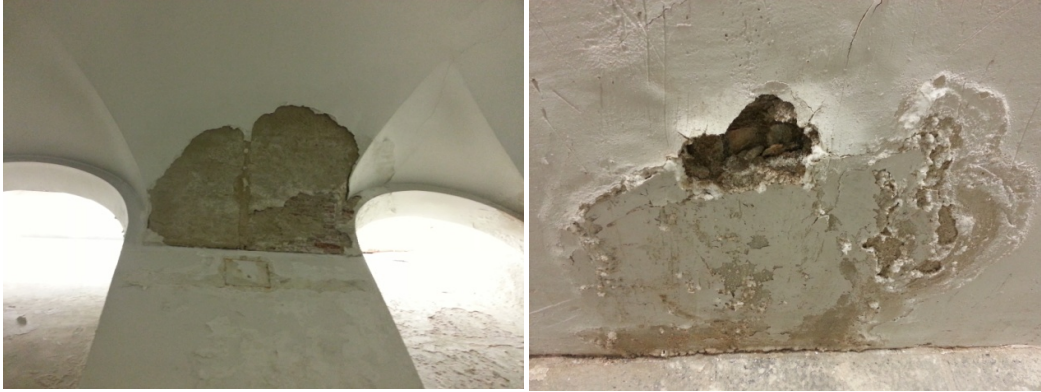
16. Bóveda y muro enlucido con cal y afectados por el agua. Se observan hinchazones, salinizaciones y desprendimientos. Foto: Sergio Boj.
