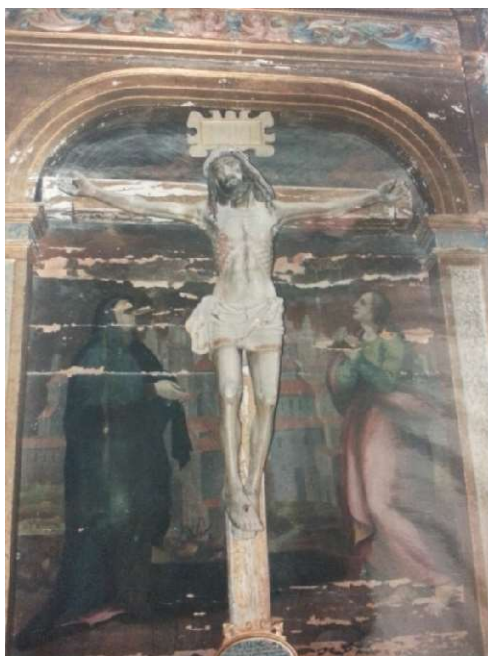
13. Vista del estado de conservación del Retablo Mayor de la iglesia de Santa Ana, en Santervás de la Sierra (Soria), antes de su restauración. La filtración de agua de lluvia a través de la cubierta provocó escorrentías en la parte superior del retablo, así como la caída de material pictórico y alteración de los soportes. Foto: Luis Priego.
