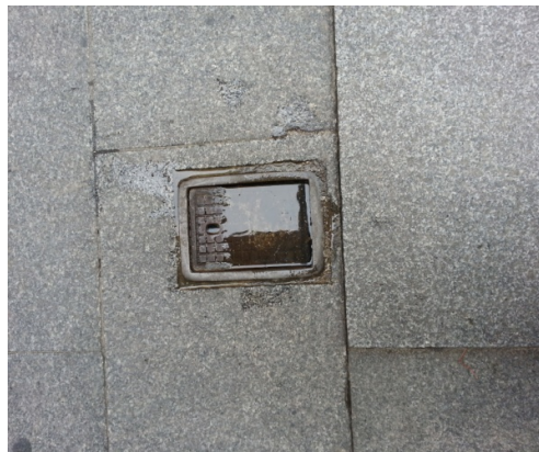
32. Toma de riego junto al templo de San Ginés. Foto: Sergio Boj.
