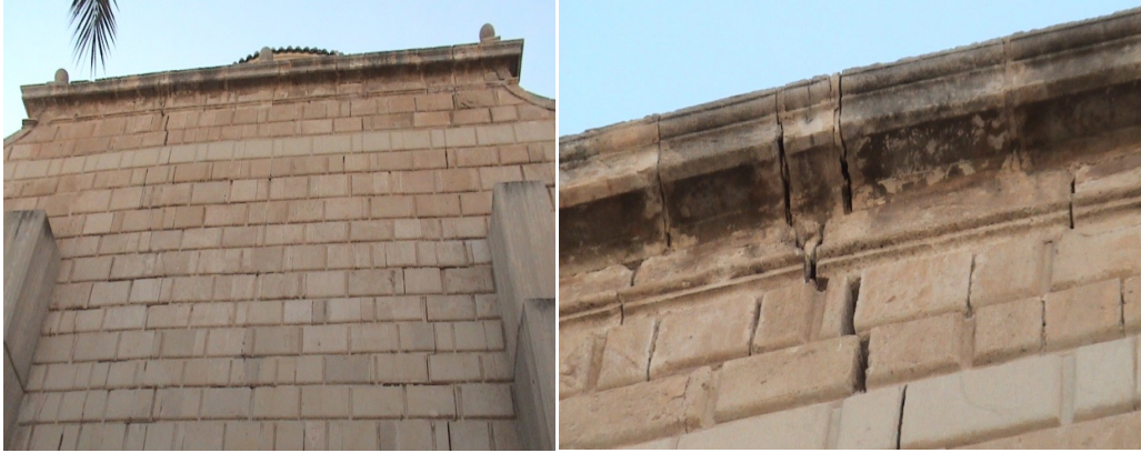
10. Vista general y detalle de la cabecera de la iglesia de los Santos Justo y Pastor de Orihuela (Alicante). Las grandes grietas aparecidas en el muro son consecuencia de la desecación del terreno debido al encauzamiento del río Segura que discurre a escasos metros del templo. Foto: Sergio Boj.
