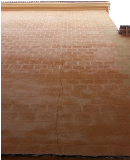
24. Grieta vertical en la cabecera de la iglesia. Foto: Sergio Boj.
