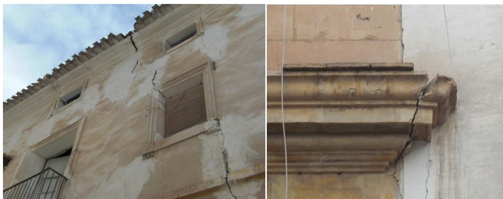
20. Daños ocasionados por el terremoto de Lorca (Murcia) de 2011 en el patrimonio de la localidad.
