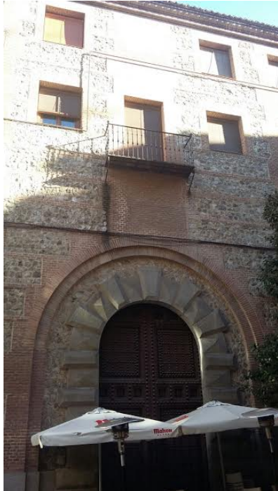
26. Mancha de óxido bajo el balcón de la fachada sur. Foto: Sergio Boj.
