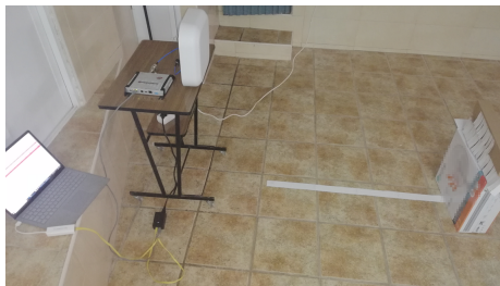
(a) Equipamiento en Interior - 1 Antena
