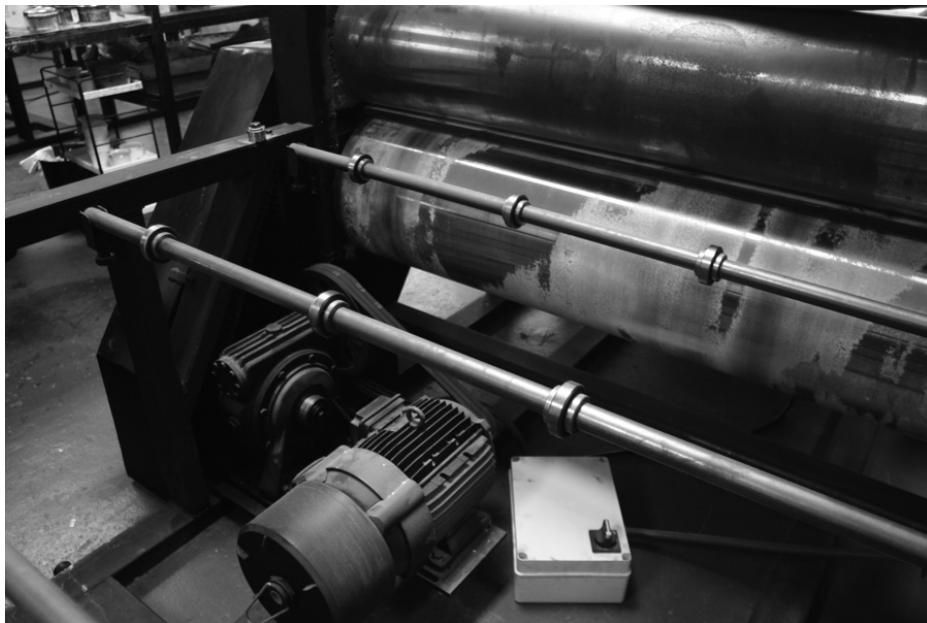
Vista del motor eléctrico instalado en un tórculo moderno para estampación calcográfica ( tracción mecánica ).
