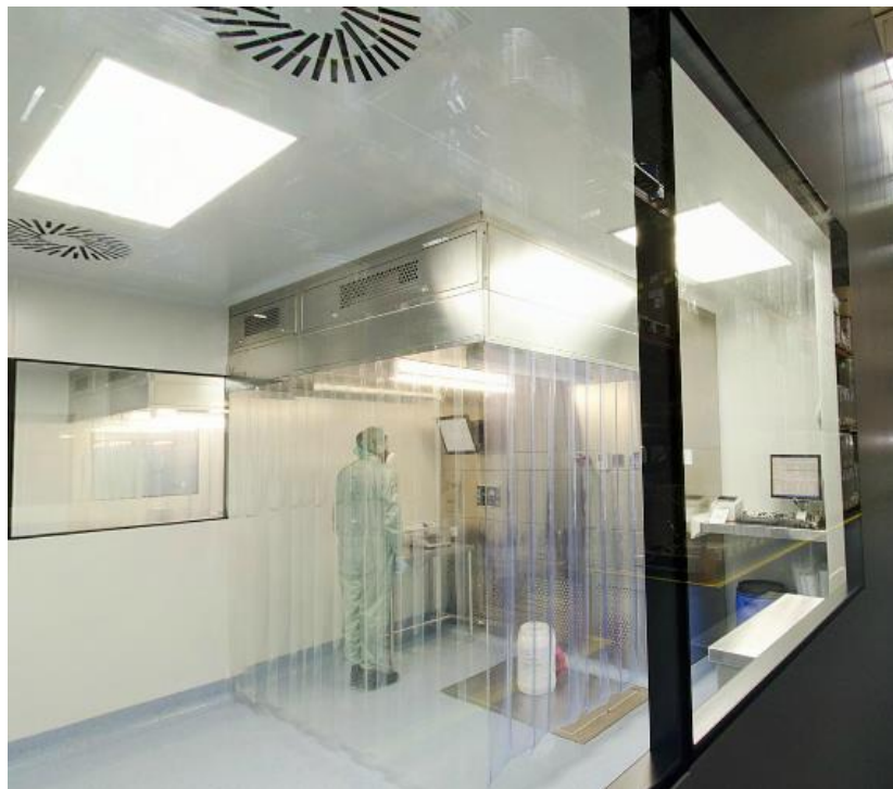
Fig. 8.6.: Cabina de pesadas de flujo laminar vertical.
