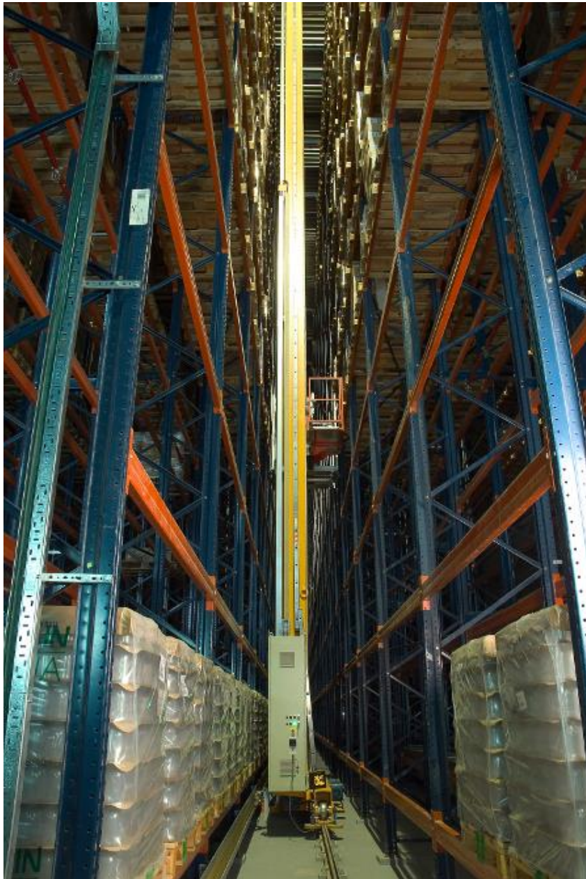
Fig. 8.24.: Almacén robotizado de pallets.
