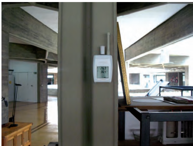
Figura 11. Ejemplo de instalación de los sensores en los distintos puntos de la sede del IPCE.
