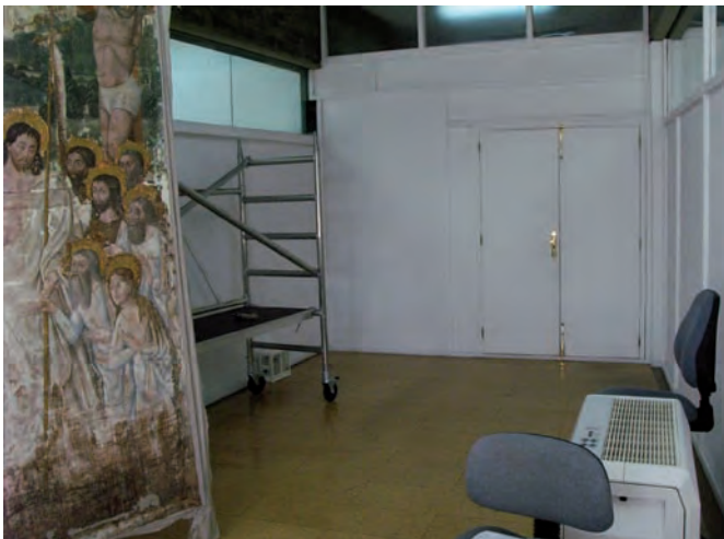
Figura 3. Sala Acondicionada 1. En la parte inferior derecha se puede ver el humidificador por evaporación.
