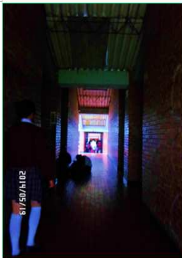
Pasillo del bloque 6, donde se ve limpio y brillante, aunque sus paderas se encuentren un poco tachonadas tienen buen aspecto.
