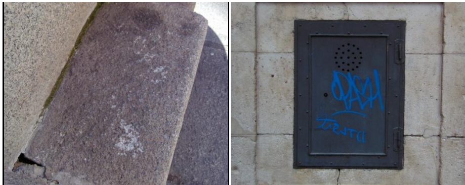
FIG. 40. Manchas blanquecinas en la estructura de granito de la fuente.
