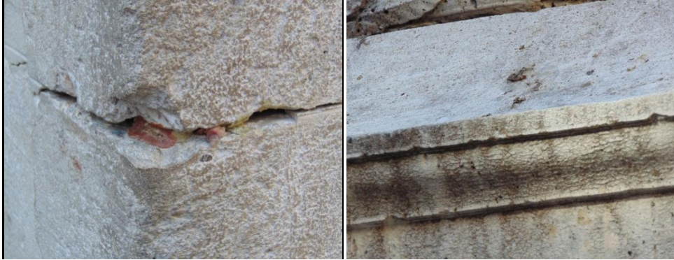
FIG. 34. Chicles pegados en el interior de una pérdida en el pedestal de la cruz.
