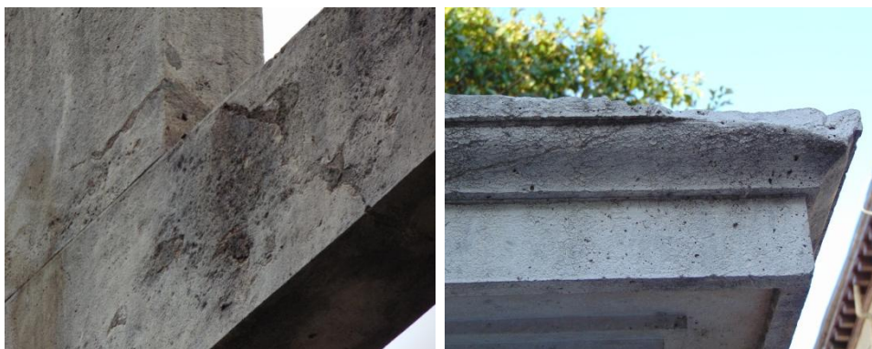
FIG. 28 y 29. Desconchados en la cruz y desprendimientos en el alero del pedestal.
