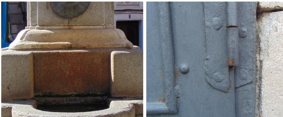
FIG. 36 y 37. Mancha de herrumbre y pérdidas de recubrimiento del hierro forjado.
