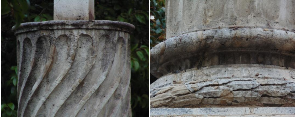
FIG.38 y 39. Lavado diferencial en la columna sobre la que apoya la cruz.
