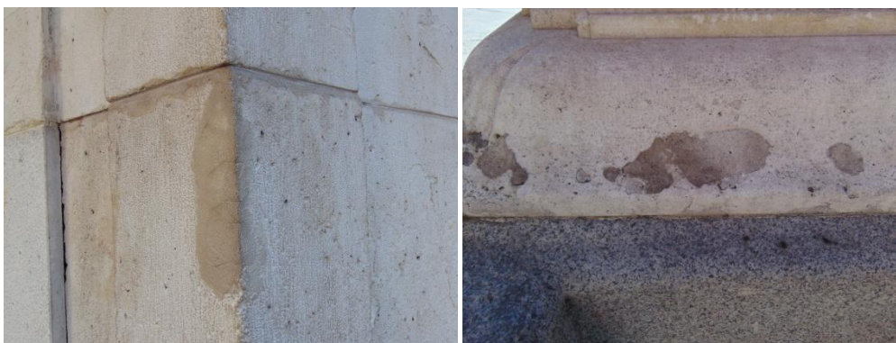
FIG. 46 y 47. Reconstrucciones volumétricas con morteros que no llegan a integrarse con la caliza de la cruz y la fuente.
