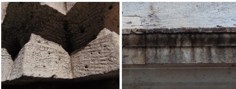
FIG. 24 y 25. Disolución diferencial en cornisas de la fuente y microdescamación en la cruz.
