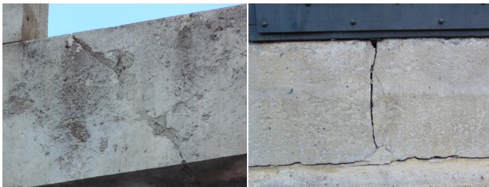
FIG. 42 y 43. Fractura diagonal y vertical en la cruz y el pedestal, respectivamente.
