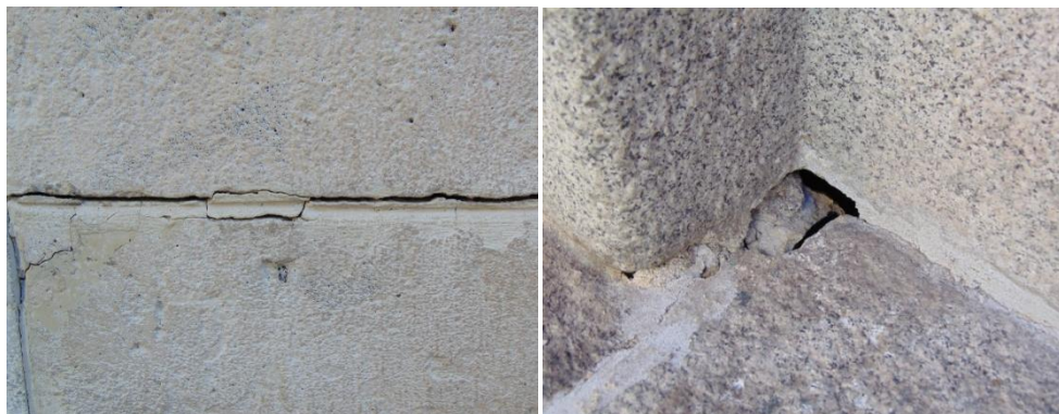
FIG. 44. Separación entre bloques y morteros de unión y agrietamiento de estos últimos.
