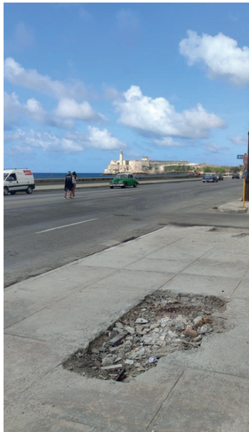
Figura 1. Socavón del Malecón de La Habana a intervenir. Fuente propia.
