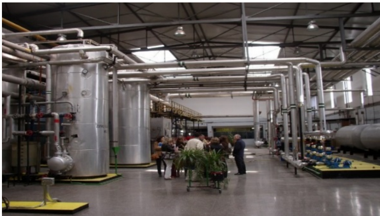
Figura 2.7. Acumuladores de ACS: Visita de inspección. Fuente: foto de la autora
