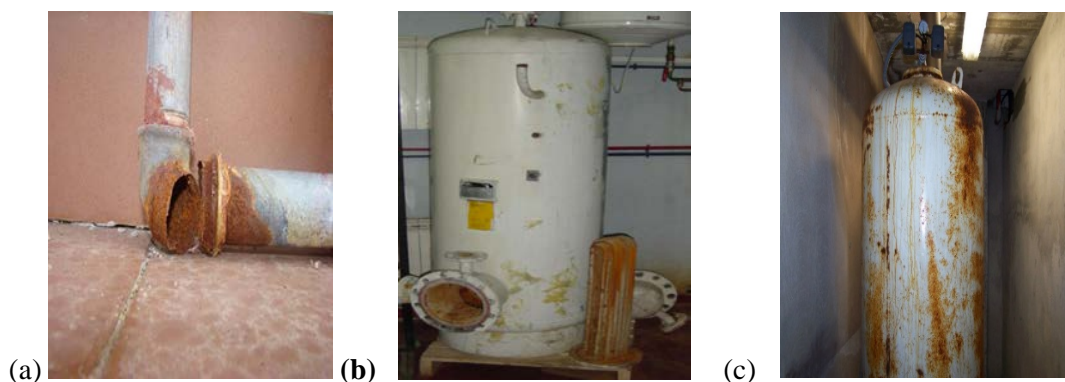
Figura 3.11. Elementos corroídos implicados en casos de legionelosis: (a) Tubería de hierro (b) Acumuladores y (c) bombas de presión de ACS. Fuente: Madrid Salud.
